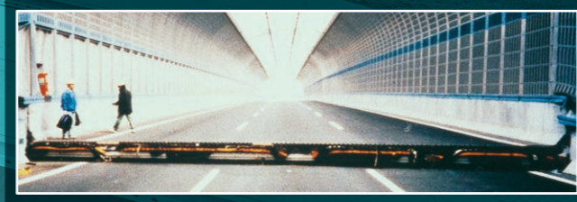
阪神・淡路大震災で路面に生じた段差や隙間 提供：阪神高速道路側
