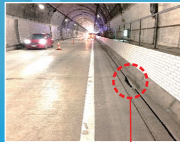
円型水路内部に堆積した損傷破片
