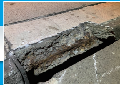
損傷した円型水路
